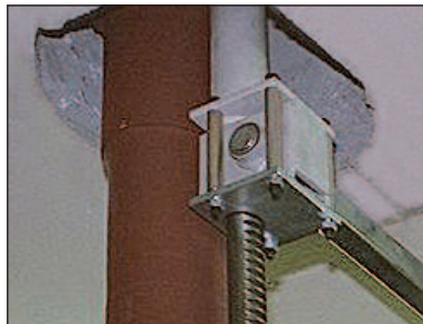
Deckeneinbau mit Getriebeumlenkung
